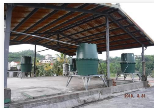
圖十七 雨水貯留系統設置
